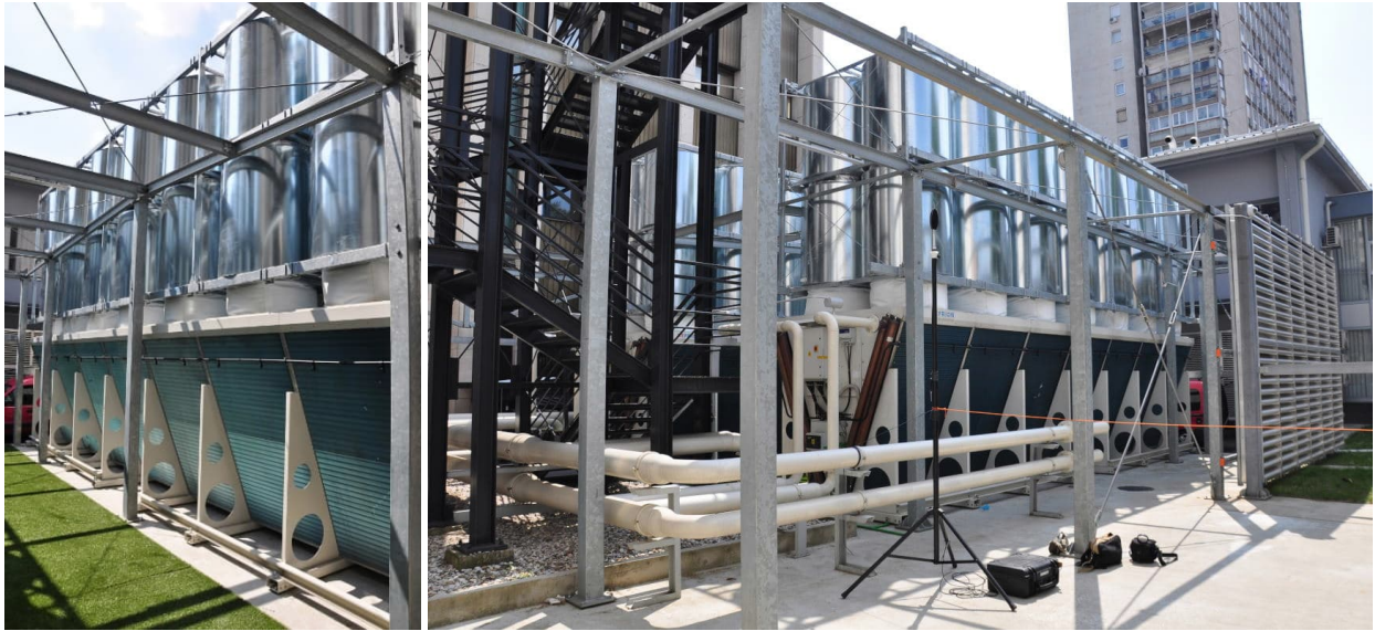
Slika 48. Prikaz ugrađenog stanja cilindričnih prigušivača buke - projekt DARH 2 d.o.o., „Zaštita od buke sustava klimatizacije i ventilacije HT Data centar, Zagreb
