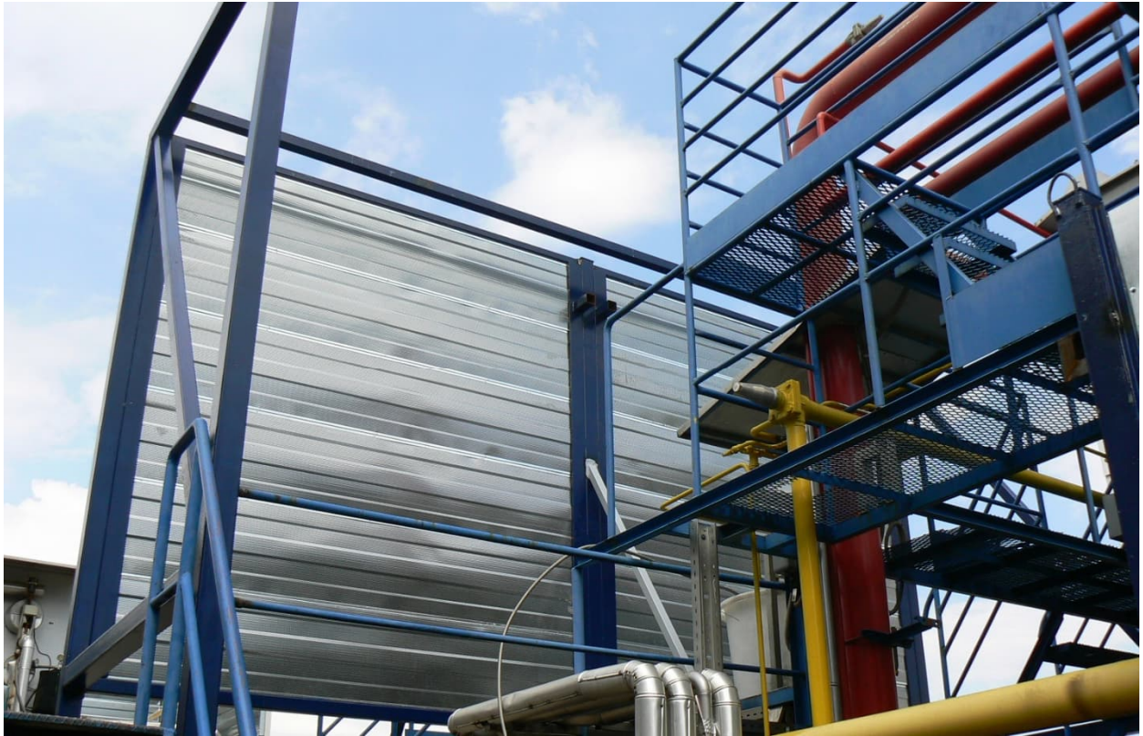
Slika 43. Karakterističan prikaz mjere zaštite od buke na vodotornju – projekt DARH 2 d.o.o., Zagrebačka pivovara
