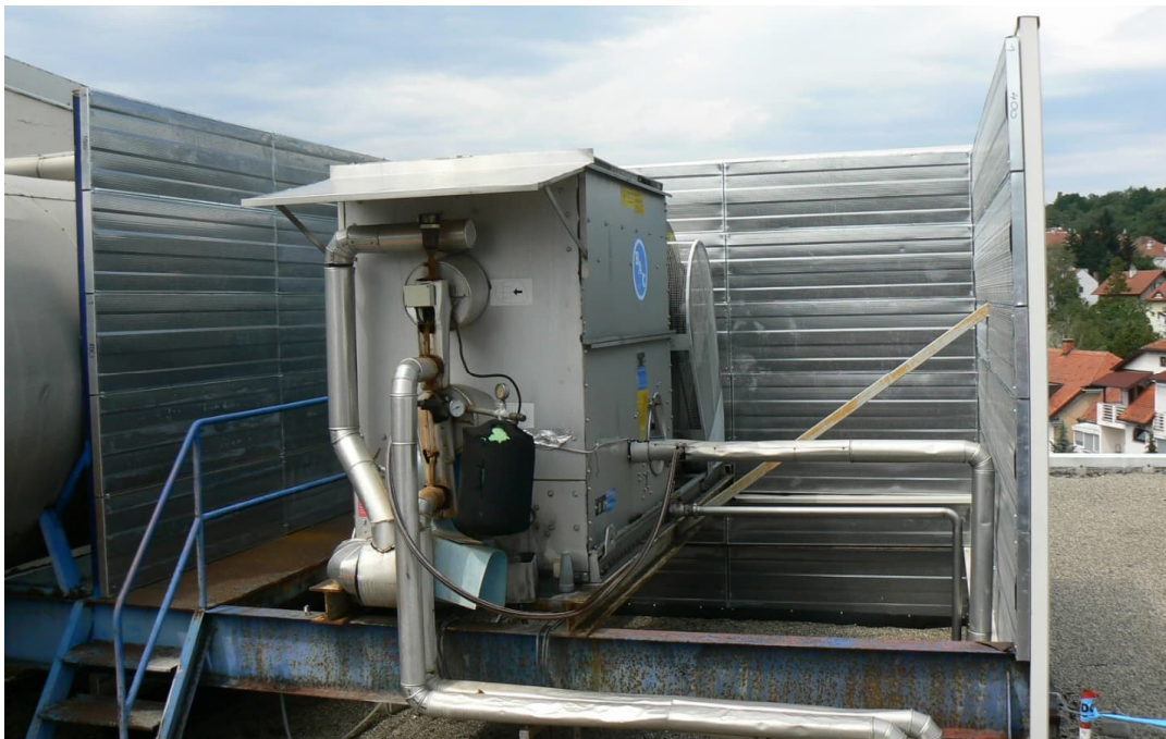
Slika 42. Karakterističan prikaz mjere zaštite od buke na kompresoru – projekt DARH 2 d.o.o., Zagrebačka pivovara
