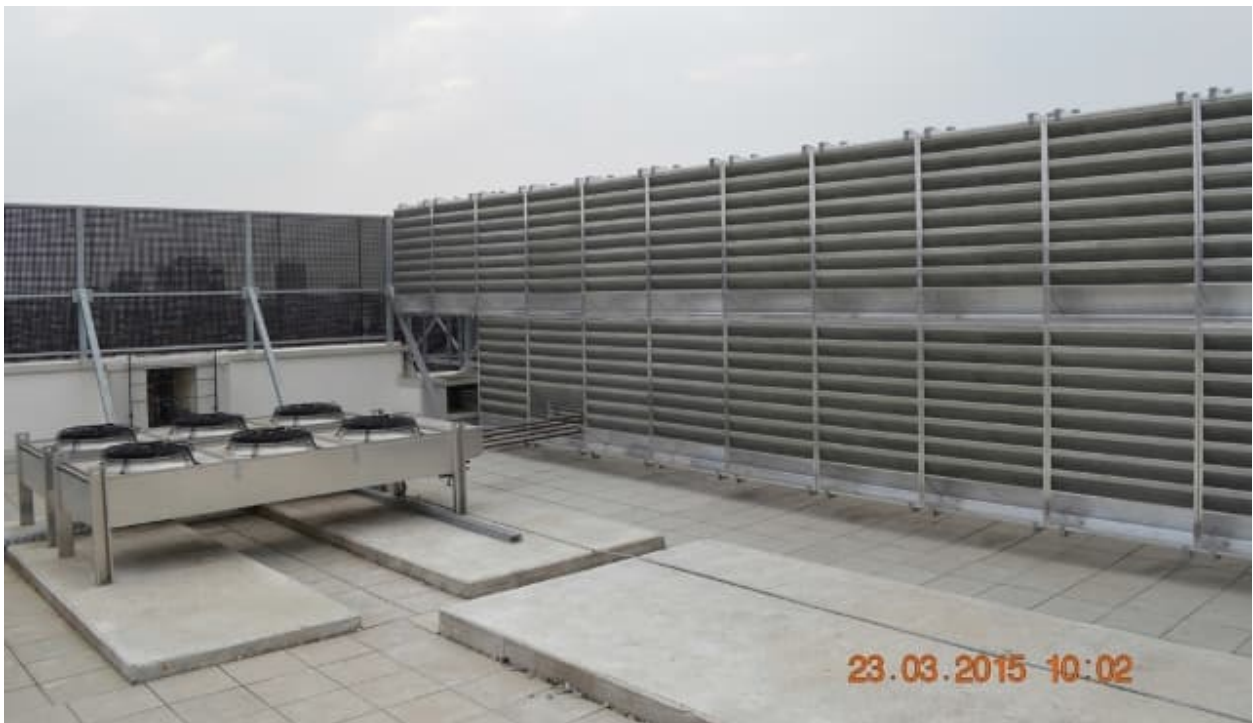
Slika 44. Karakterističan prikaz mjere zaštite od buke sustava klimatizacije – projekt DARH 2 d.o.o., HT Data centar
